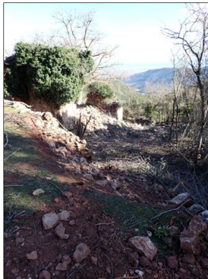
Foto 2. Imatge de la façana principal del mas (costat SO) completament enrunat.
