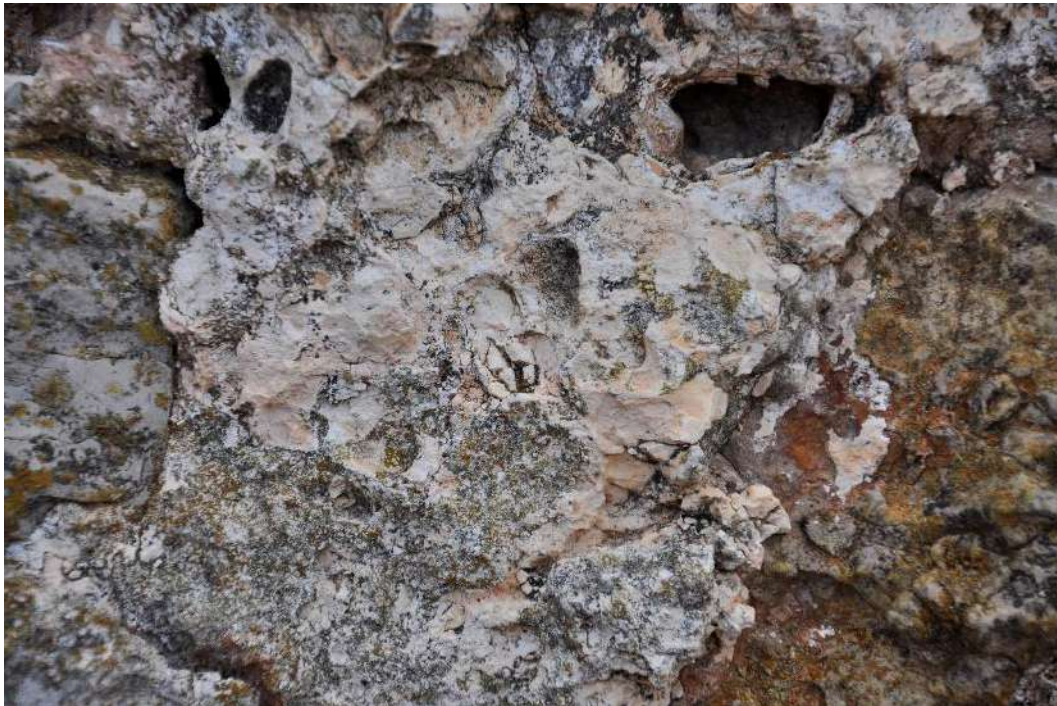
Macrofotografia dels líquens i fongs. Delaminació horitzontal del morter. Pàtina taronjada. Poca quantitat d'àrid.
