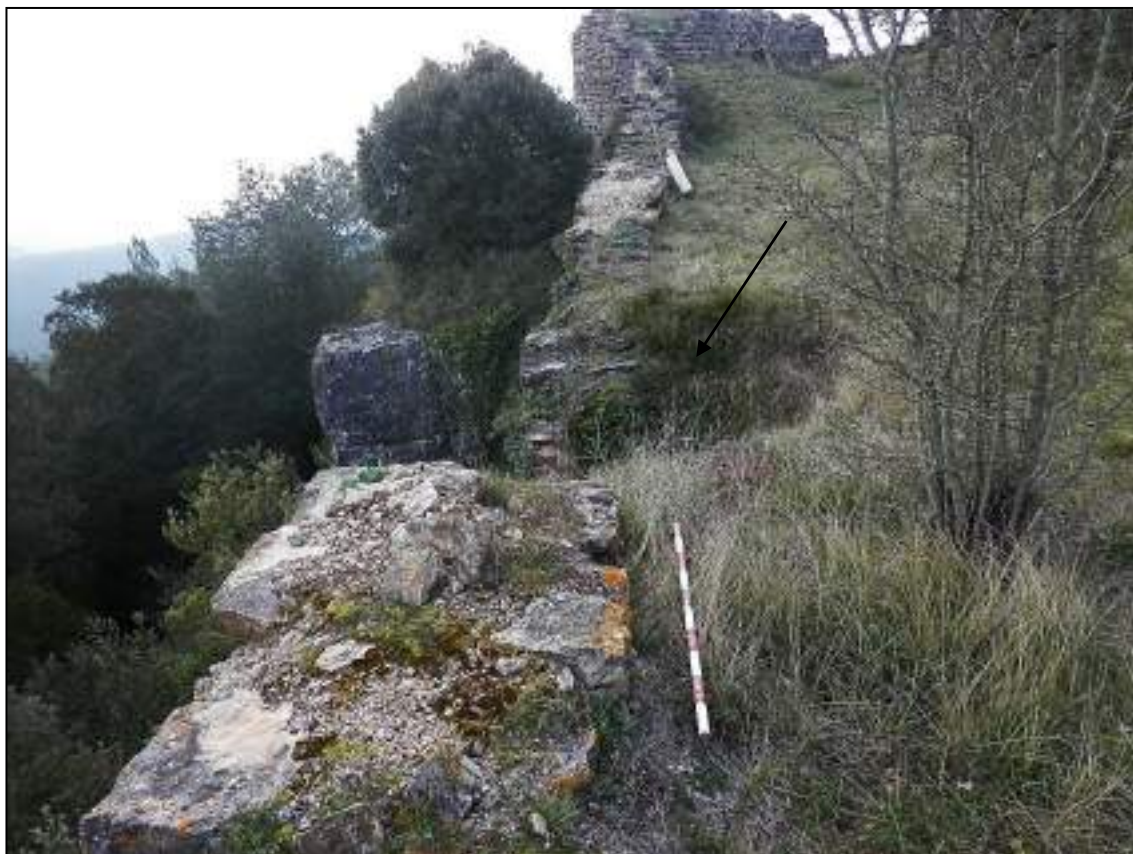
Fig. 5: Fotografies inicials de la intervenció al tram occidental de la muralla del Castell d'Albiol des de dues perspectives (NE-SE). Figura inferior: mostra de la depressió i l'afectació provocada al mur.
