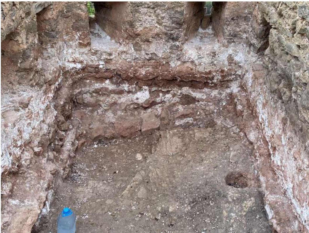
Zones amb pèrdues superficials de morter per desgast i pèrdua de cohesió. Zona inferior amb pàtina superficial vermellova per la terra que la recobria.
