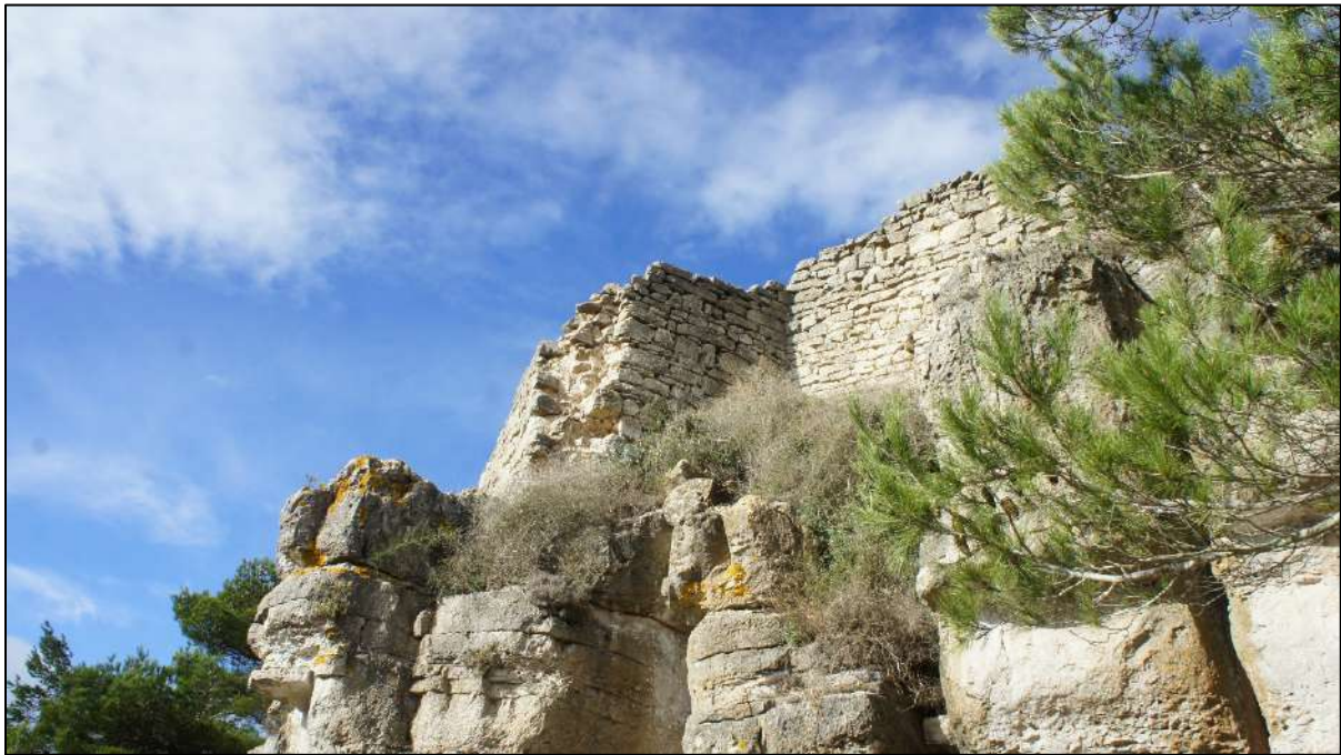
Vista exterior de la torre de l'angle sud-occidental amb les cantonades completament descarnades
